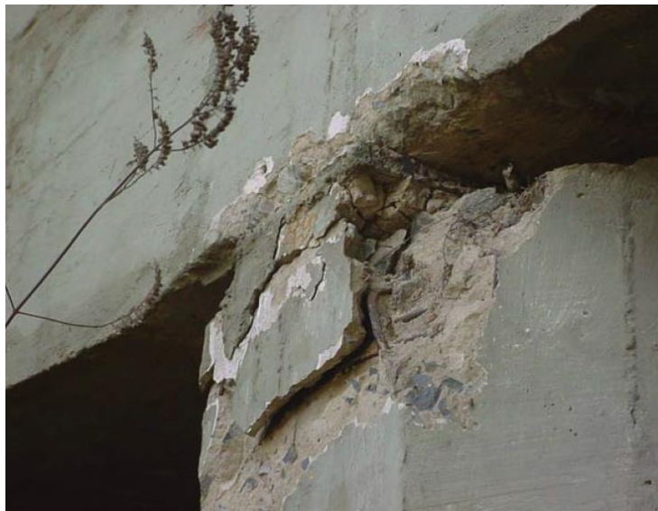
Figura 3.27 - Aparelho de apoio inadequado: Esmagamento do concreto no topo do pilar e fundo da viga principal (DNIT, 2010)
