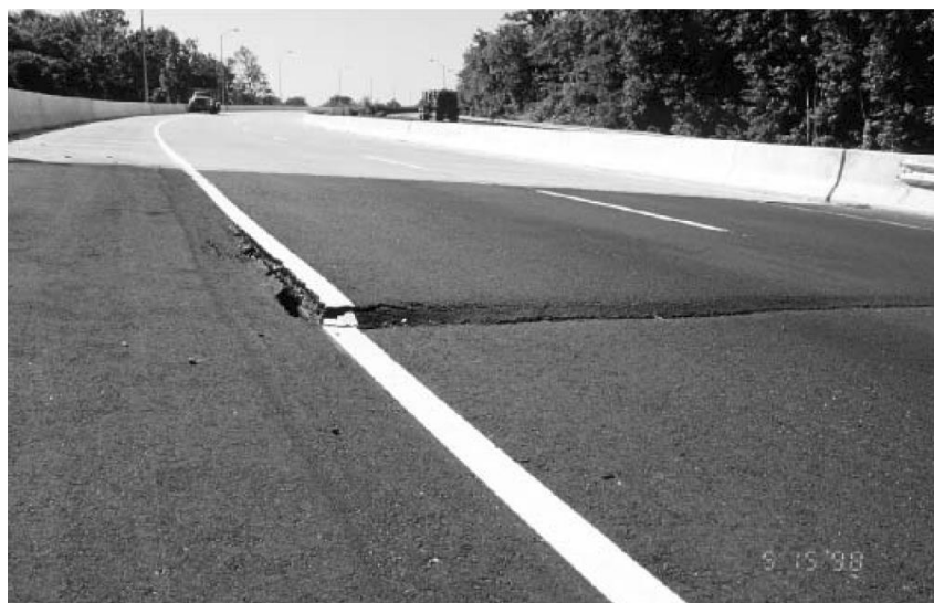
Figura 3.19 - Recalque diferencial na aproximação da ponte. (Hoppe, 1999)
