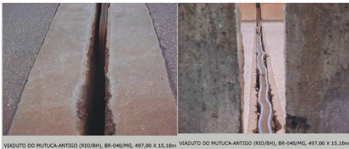
Figura 3.28 - Junta mal projetada e/ou executada, desgastada e ineficaz (DNIT, 2010)
